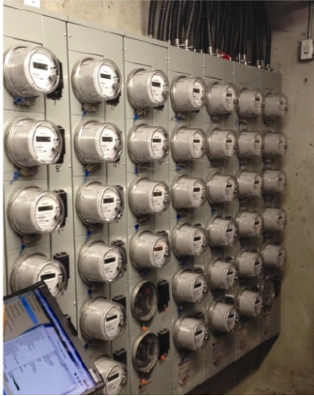
图11-14 公寓楼中的地下仪表场
